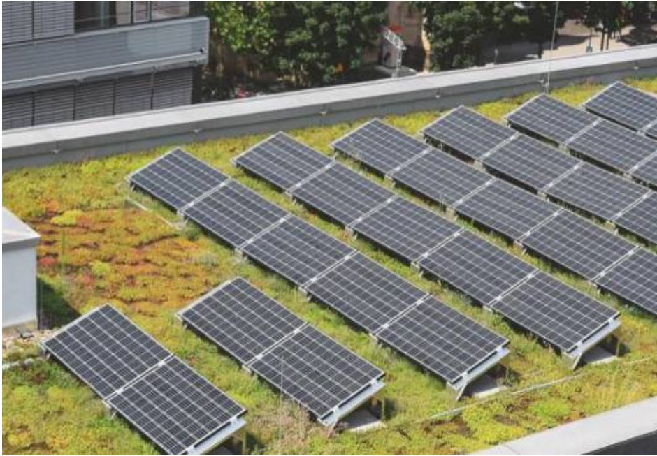
Abbildung 34: Solargründach Industrie (Quelle: https://neulandschaft.de/media/Ausgaben/2021/NL-2021-11/ein_grosser_nutzen_das_solar-g/pv_mann-09.jpg )
