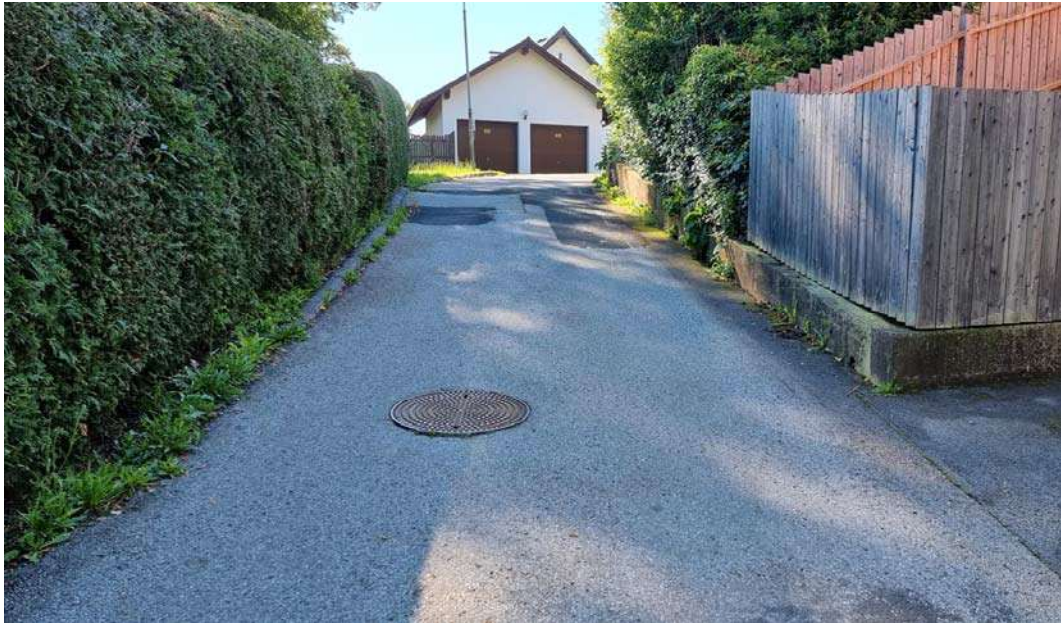
Straßenabschnitt mit einragender Hecke auf Straßengrund
